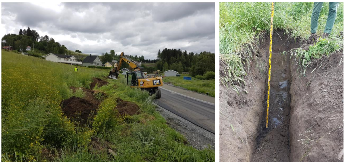
Illustrasjon 35: Bilder. Venstre - graving av prøvehull for etablering av overflateinfiltrasjon, høyre - sjakting av prøvehull
