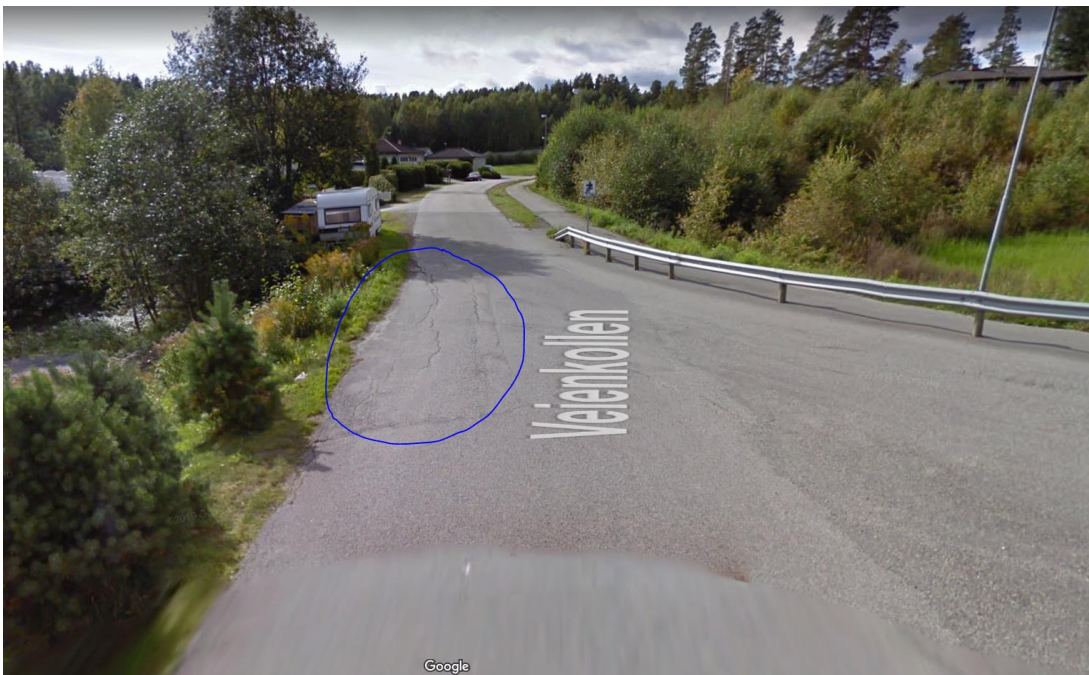
Figur 6 –Bilde fra Veienkollen, som viser små setninger i veikanten, sør-øst for planområdet Veienkollen boligfelt. (Kilde: google. maps)
