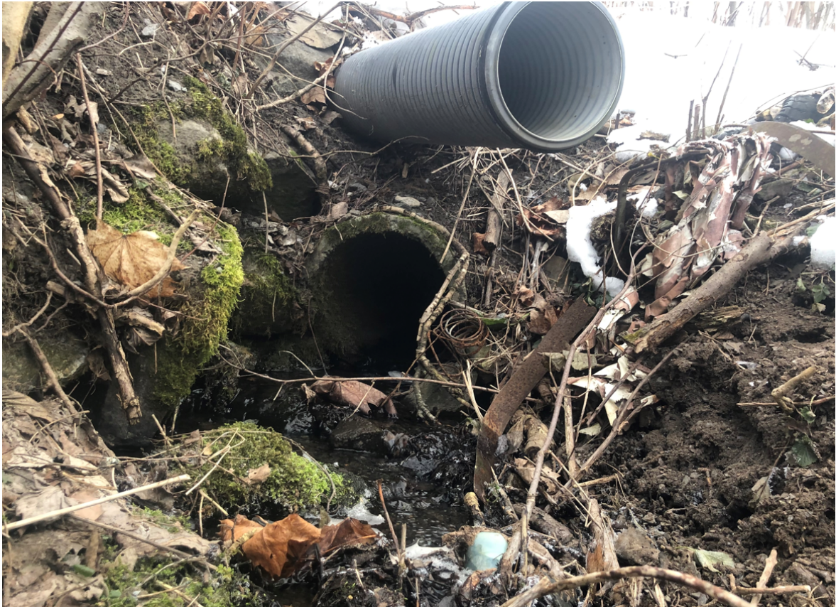
Figur 6-2- Stikkrenne Hvalsveien, innløp.
