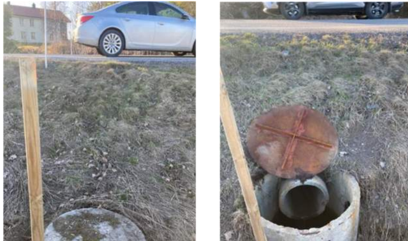
Figur 4 Stikkrenne 1 føres til kum. Diameter målt til Ø30 cm
