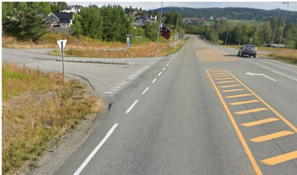
Figur 15 Google earth. Stikkrenne under avkjøring. Synes ikke på bildet.
