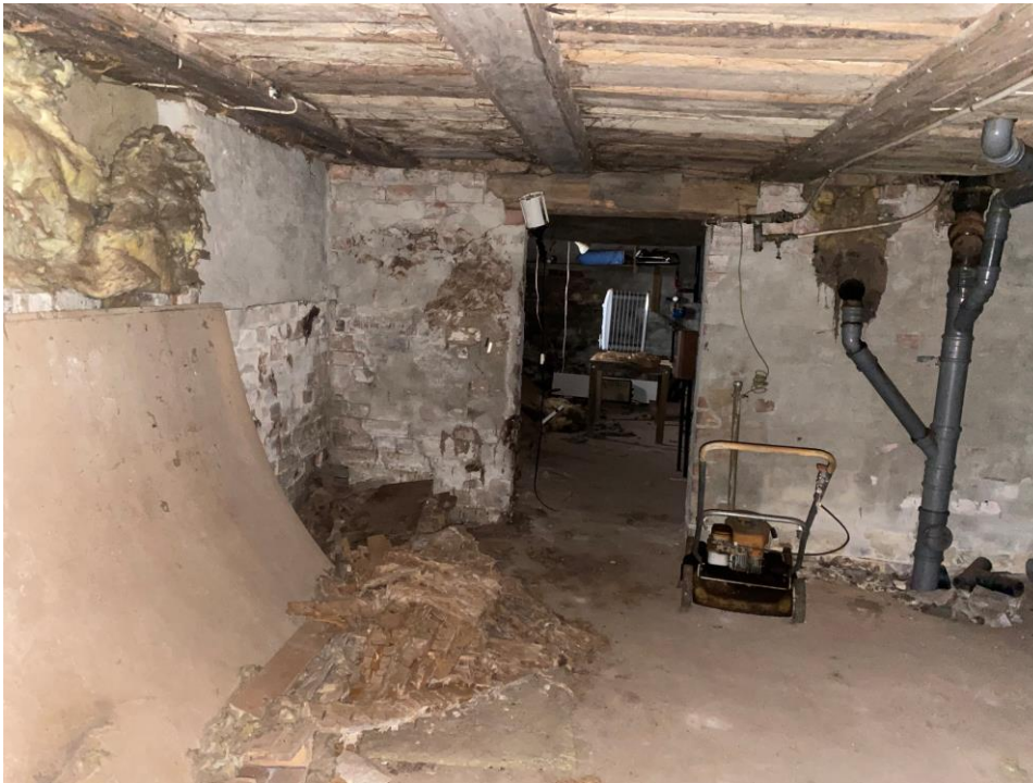
19. Dårlig grunnmur og trekonstruksjon i kjeller.
