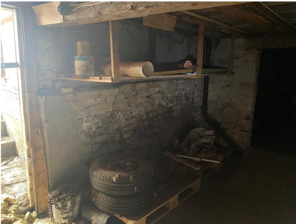
18. Dårlig mur i kjeller.
