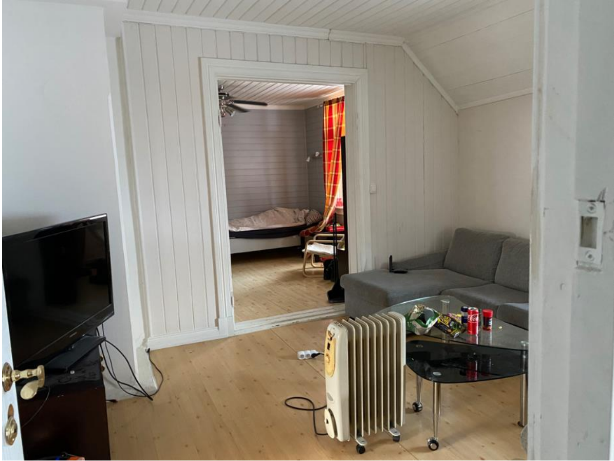
Rom 09 stue sett mot sørvest mot rom 10. Opprinnelig døråpning og gerikter, nytt gulvbelegg.
