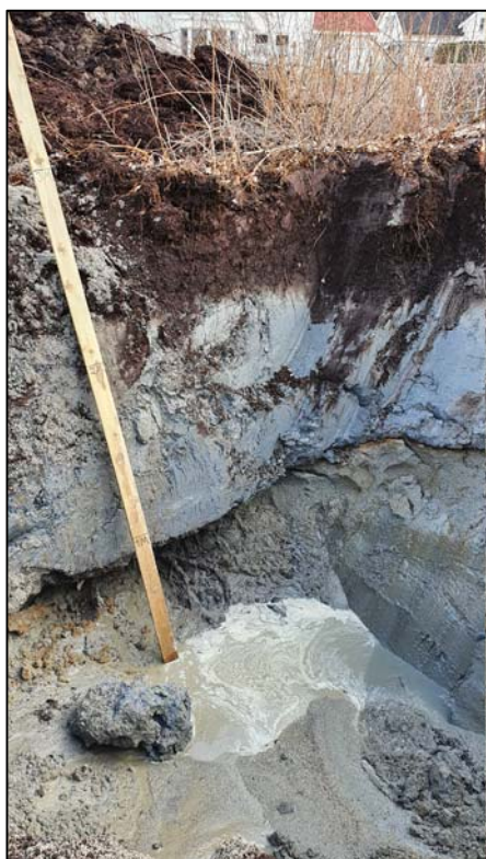
Bilde av prøvehull, vekstjord over leire med innslag av grus.
