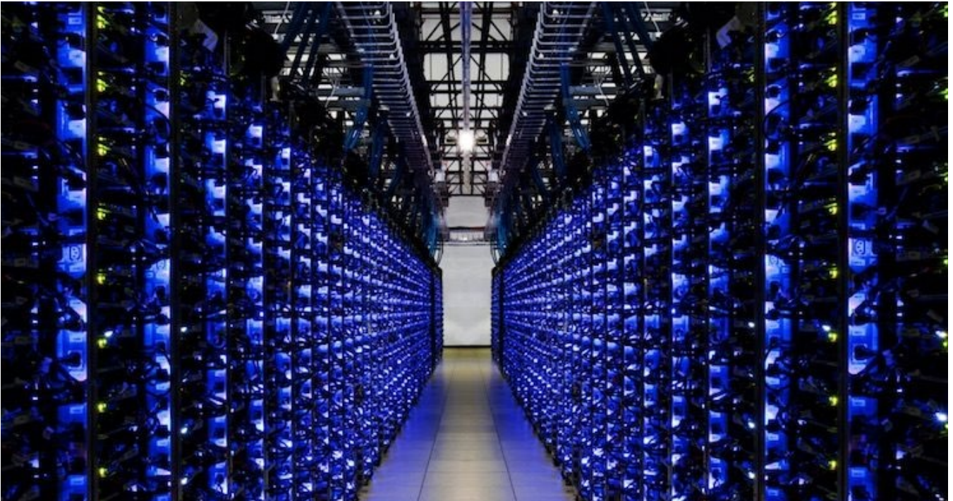
Figur 18 Eksempel på datasenter rack (Kilde: datacenterfrontier.com [13])
