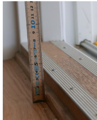
Manglende trinnfri tilgang til terrasse og bod i nytt boligprosjekt.
